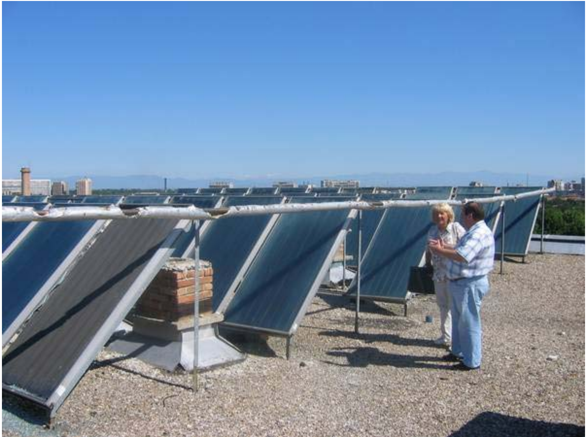
Общ вид на колекторите, на покрива
