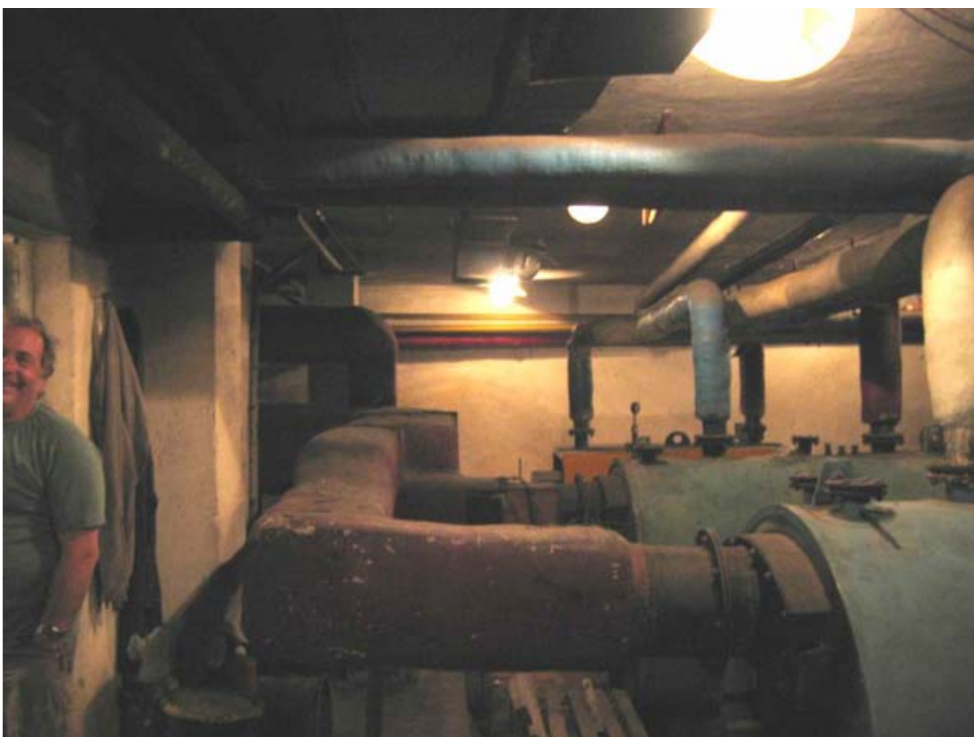
Общ вид на котлите
