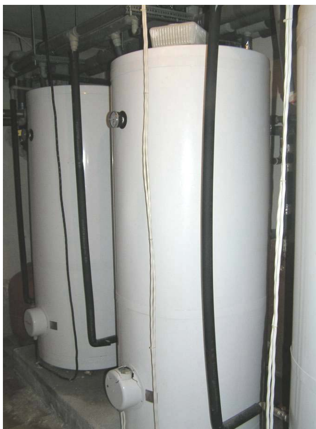
Фигура 3. Котелна инсталация в хотел „Елит“
