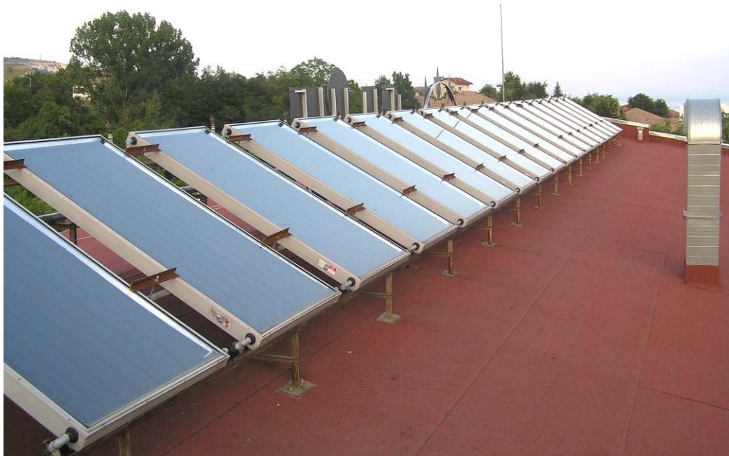
Фигура 1 Слънчеви колектори на покрива на хотел „Елит“
