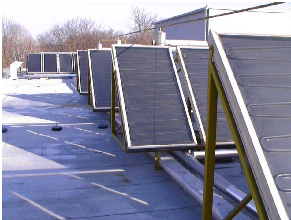
pogled na polje kolektorjev
